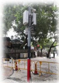
Sistema de Monitorização Digital da Cidade de Macau
