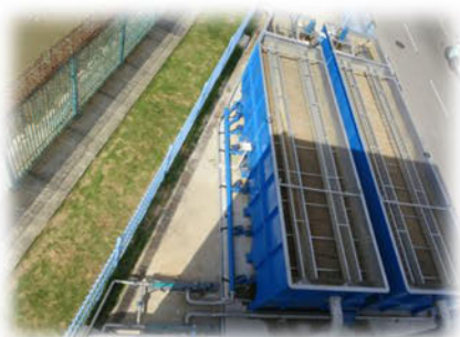
Instalação de pré-tratamento de águas residuais
